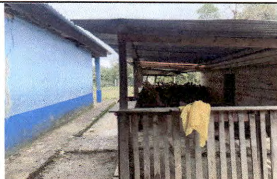
Foto 10: Barranda de cocina en mal estado.
