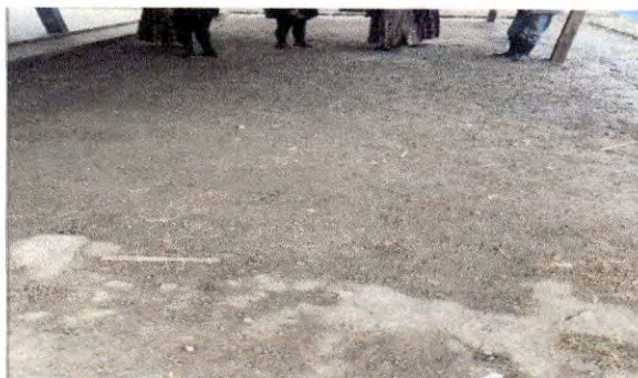
Foto 6: Patio en mal estado.
