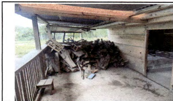
Foto 5: Bodega de cocina destruida.
