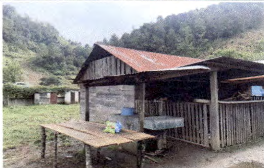
Foto 7: Estado de cocina en malas condiciones.
