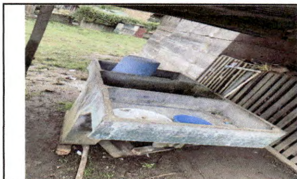
Foto 3: Pila de concreto muy desgastado y quebrada.
